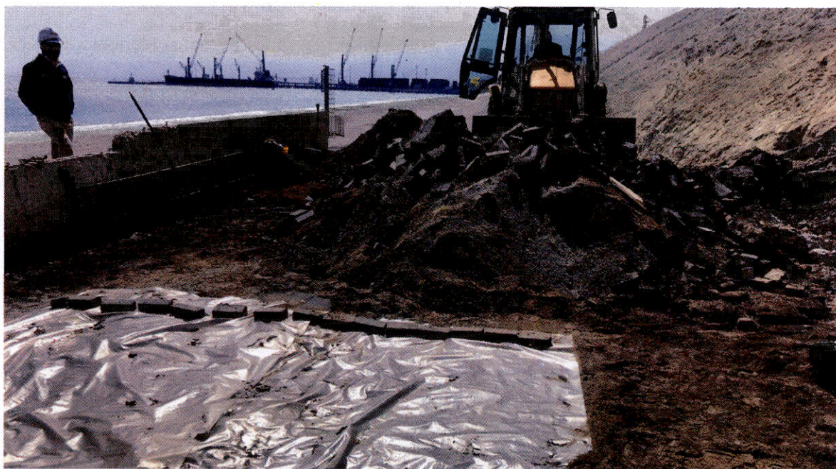
Img 2. Derrame de combustible fuel oil desde las instalaciones de INTERACID Chile (Mejillones) la cual presta servicios a Planta COPEC (OLEODUCTOS). Proceso de retiro de arenas contaminadas por derrame de fuel oil .
