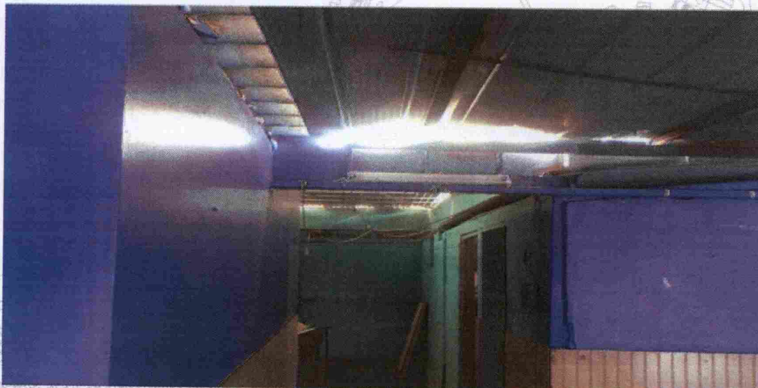
AREAS CONSIDERADAS -PROBLEMAS EN CIELOS, MATERIALIDAD DE MUROS O CUMPLEN CON NORMATIVA DE SEGURAD: RESISTENCIA A FUEGO.
